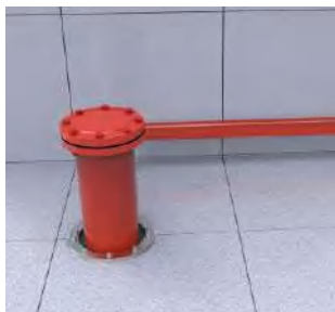
喷淋灭火系统 Fire sprinkler system
