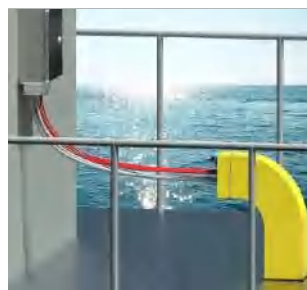
电源变电站 Power substation
